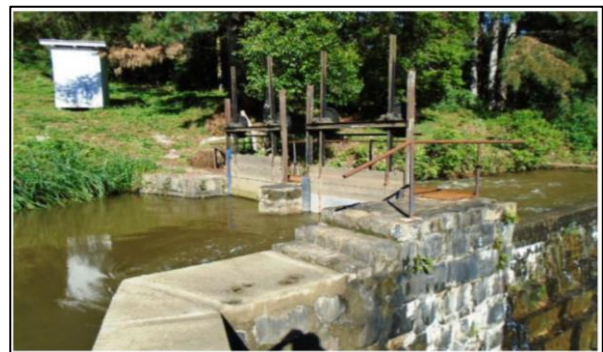
Tomada de água do circuito de geração
